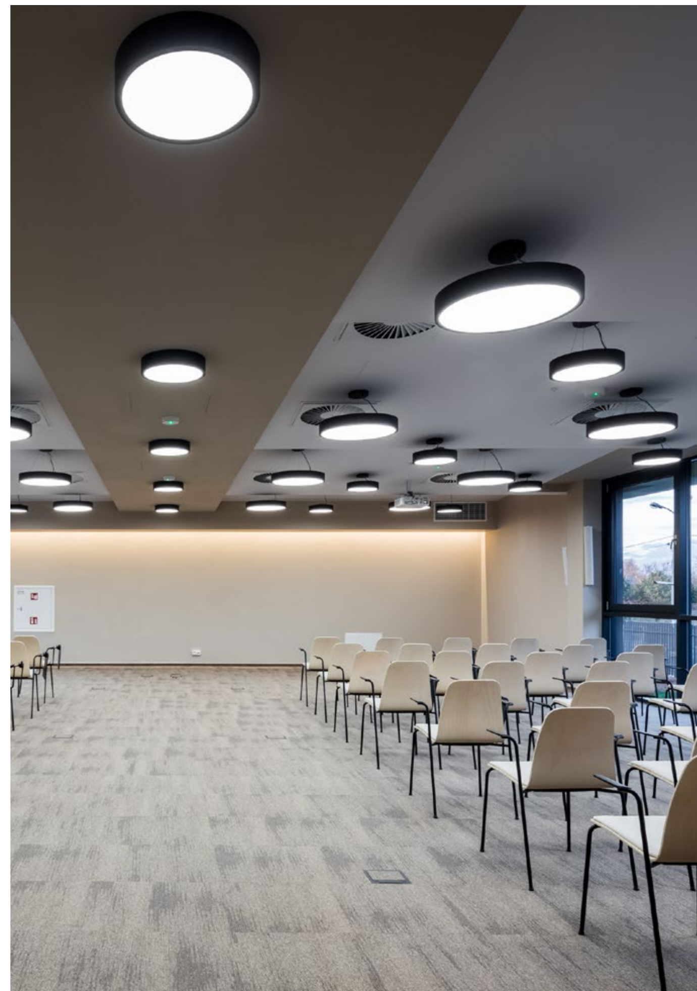
Zastosowanie systemu Coria LED w sali konferencyjnej w Centrum Misji Afrykańskich w Borzęcinie Dużym.
