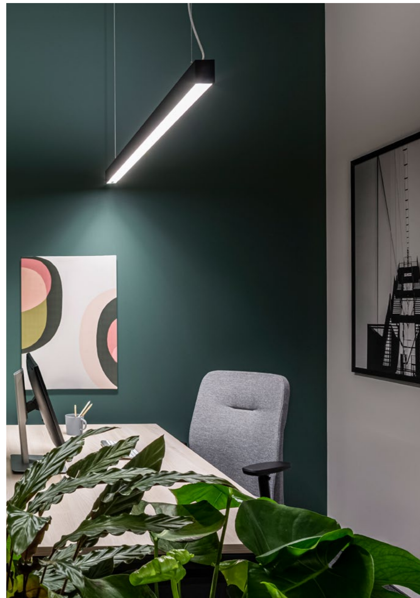
Zastosowanie lampy Baris 40 LED UGR w biurze.
